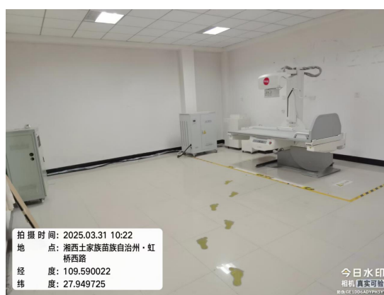
放射二室（DR 机房）内部
