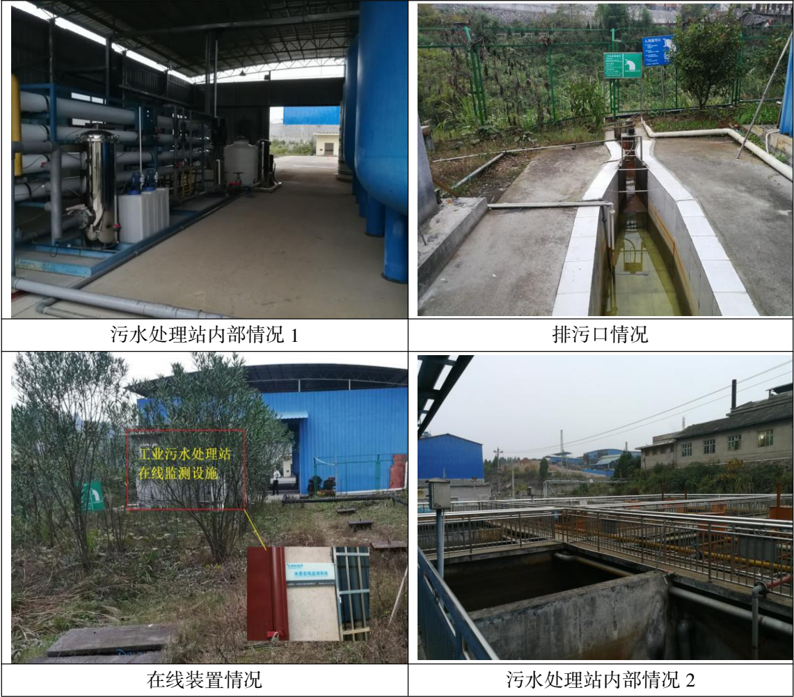
图 3.2-2 钟灵山工业污水处理站现状情况
