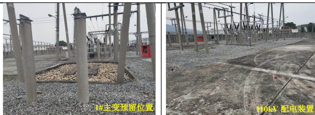
浦市 110kV 变电站站内
